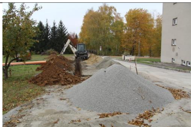
inženýrské sítě na křižovatce Jabloňové a 17. listopadu
